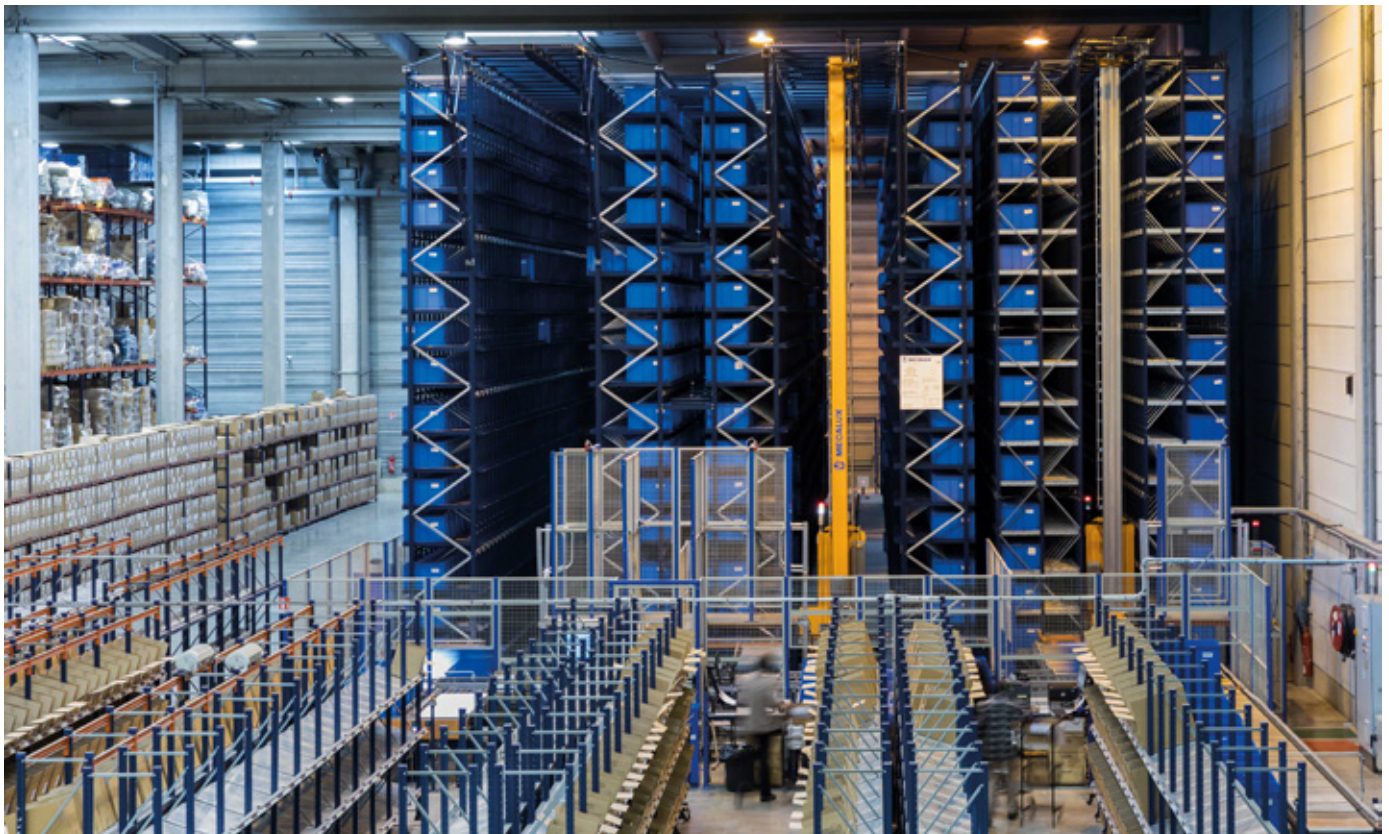
Imagen que representa una solución similar a la instalada en el almacén de Groupe Rand
